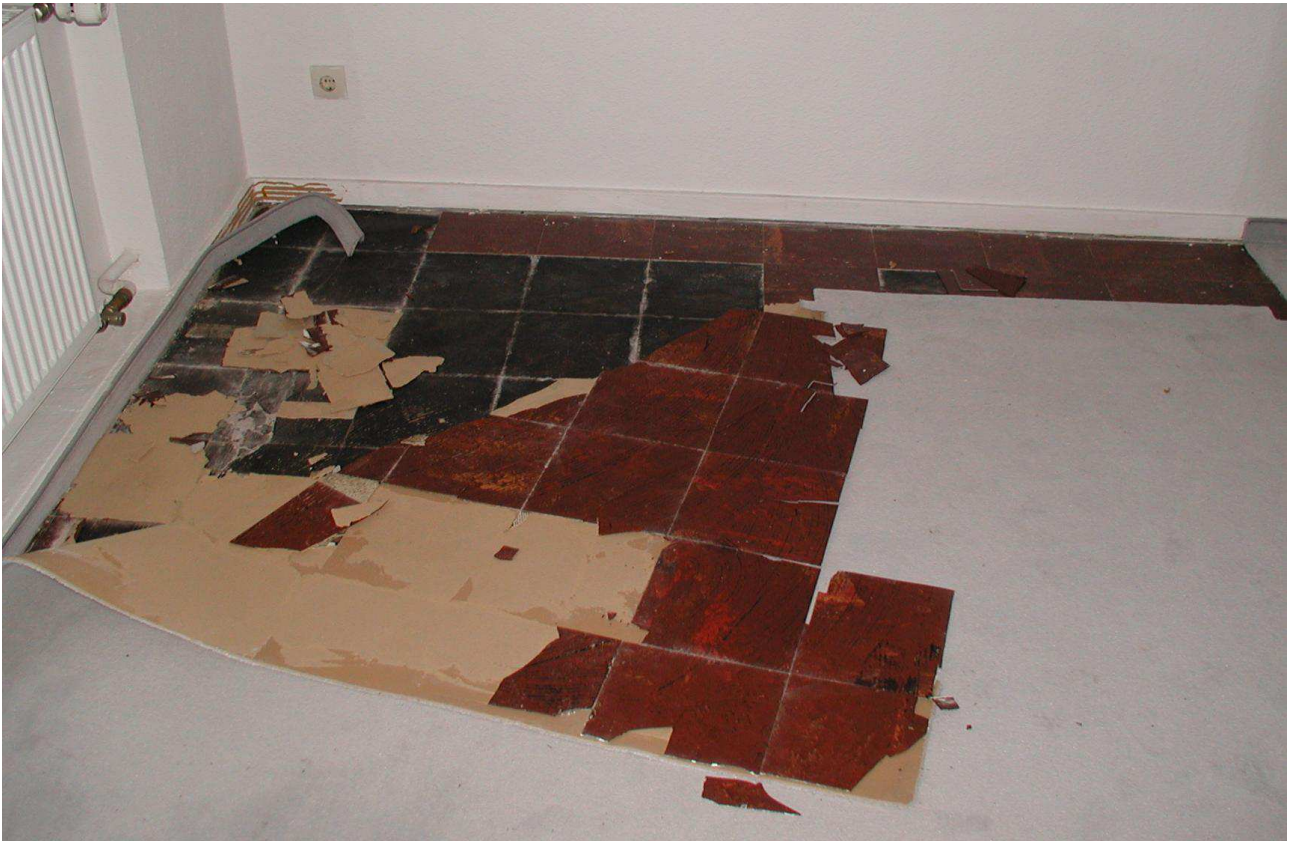
Bild1: Alte, brüchige und asbesthaltige Vinyl-Asbest-Fliese (Flex-Fliese/Marley-Platte) aus den 60er Jahren auf PAK- und asbesthaltigem Bitumenkleber – ein Sanierungsfall für ein Fachunternehmen
